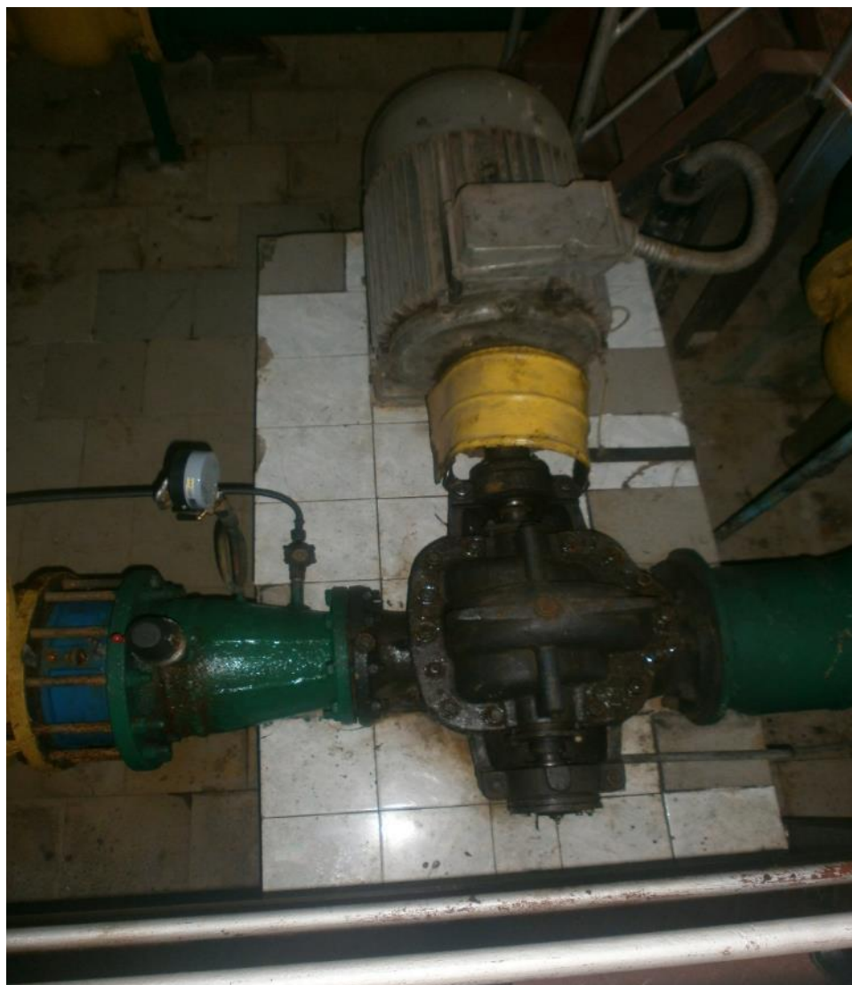
Рисунок 27. Насос станции подачи воды на фильтры 2-й ступени.
