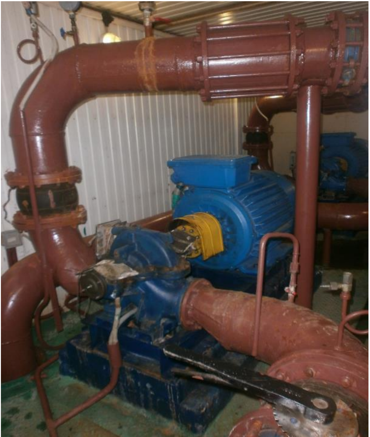
Рисунок 40. Насосное оборудование НС-3 «Назымская».
