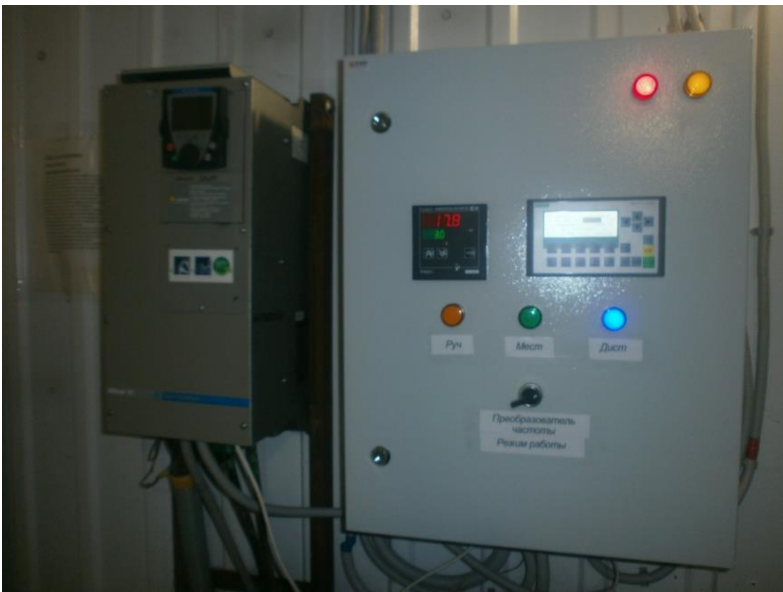
Рисунок 13. Шкаф управления насосом.
