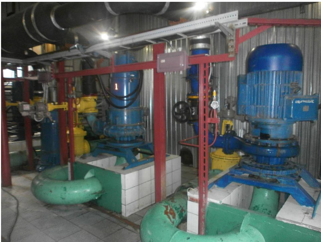
Рисунок 22. Внутреннее помещение насосной станции подачи воды в аэратор с насосными агрегатами.
