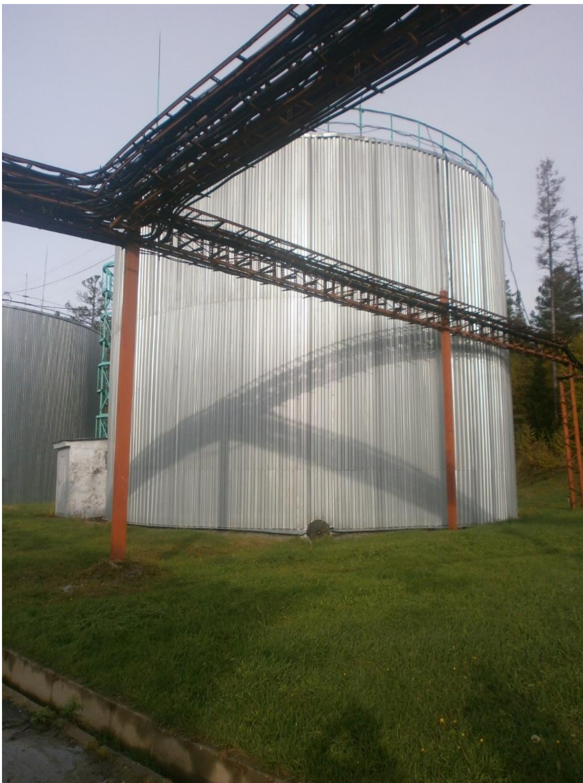
Рисунок 28. Резервуар чистой воды объёмом 2000 м 3 .
