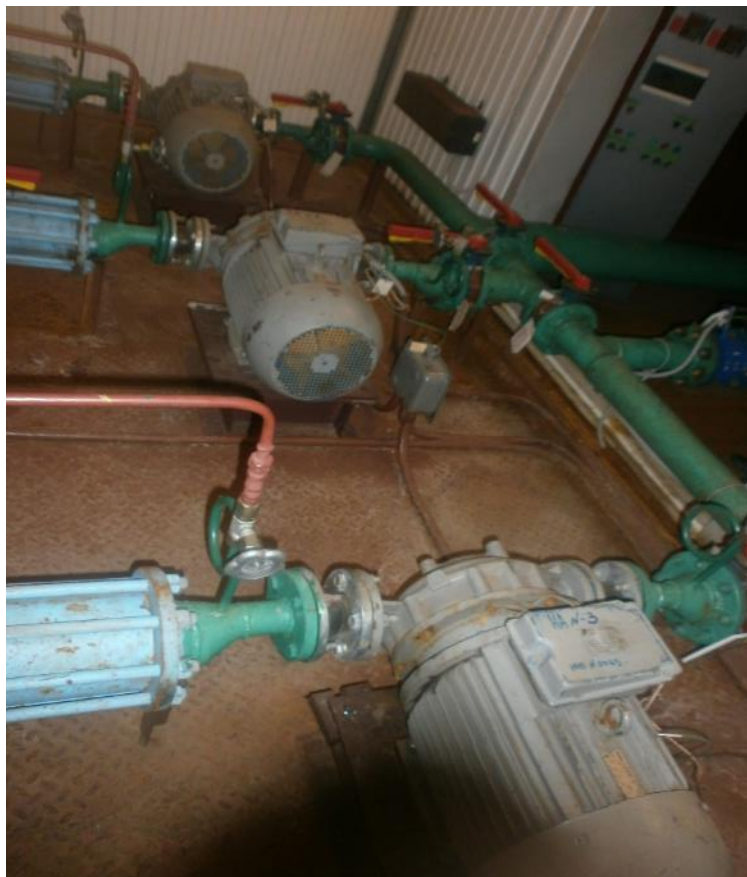
Рисунок 42. Насосное оборудование НС-3 «Метеостанция».
