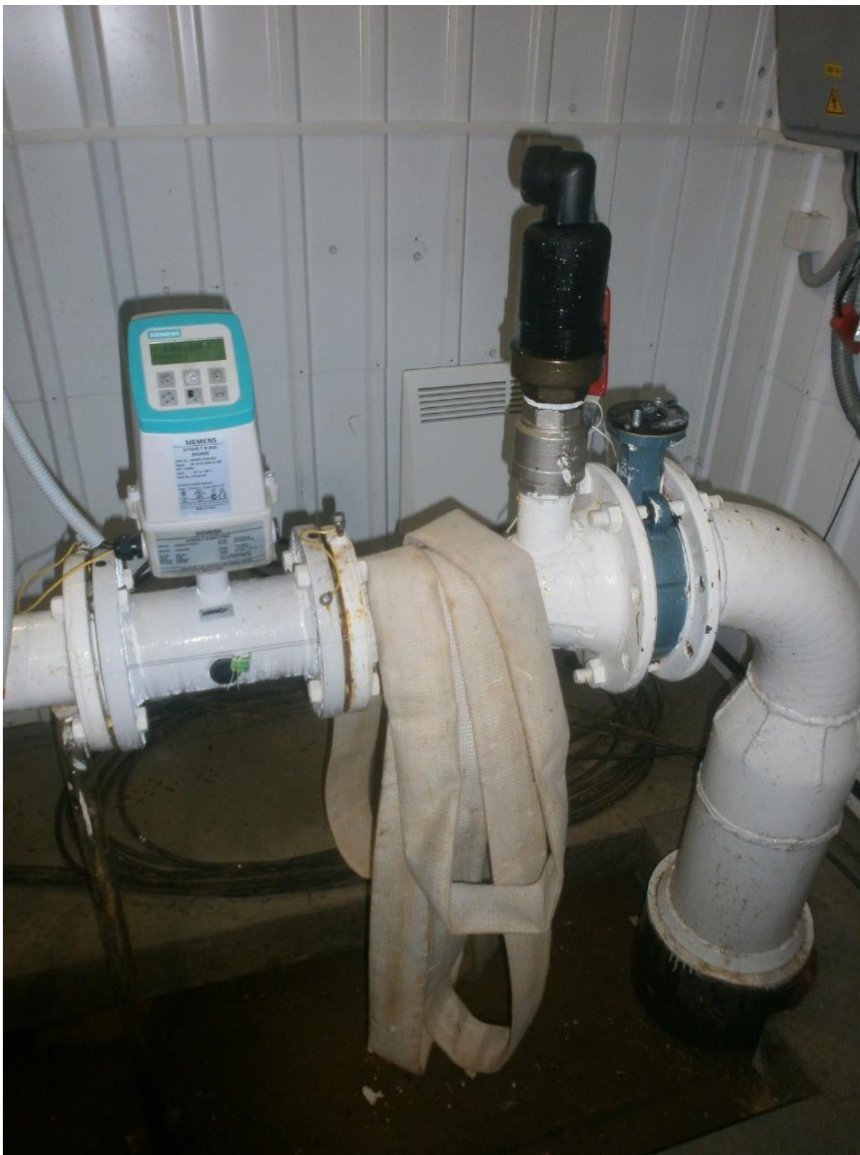
Рисунок 14. Расходомер, установленный на скважине №29.
