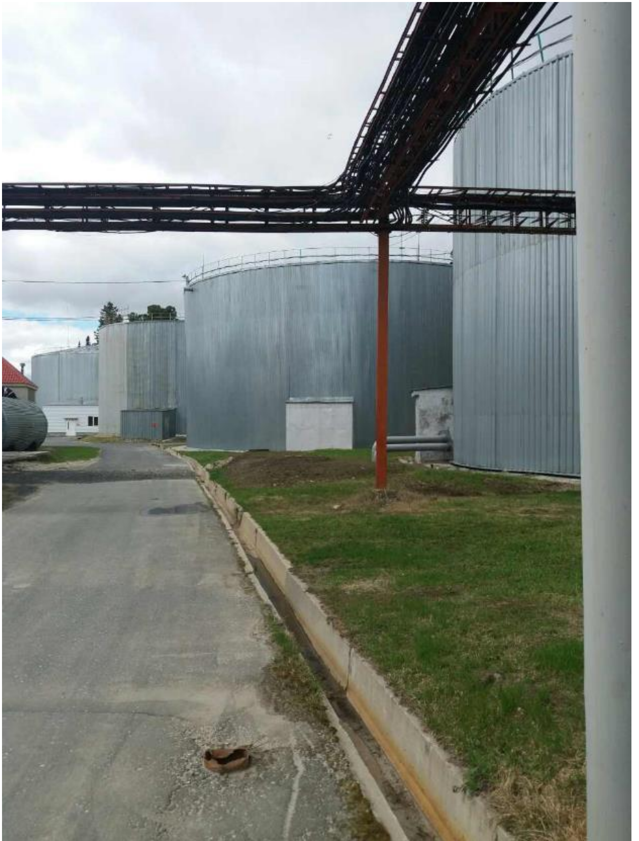
Рисунок 29. Резервуары чистой воды.
