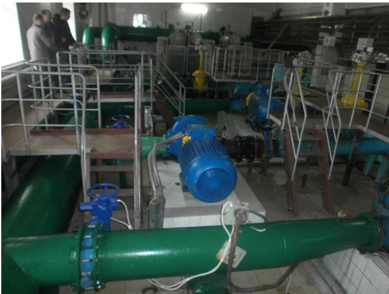
Рисунок 36. Машинный зал, насосной станции 2-го подъема.
