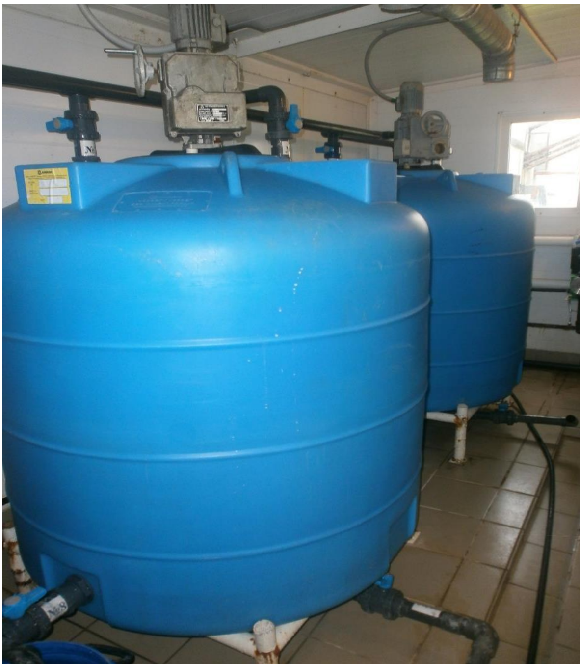
Рисунок 32. Баки для приготовления раствора хлорной воды.
